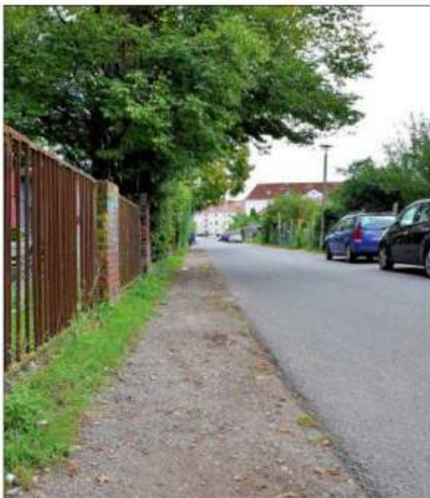
Auf der Ostseite des Emanuel-Larisch-Weges verläuft ein unbefestigter Seitenstreifen als Gehweg. Dieser ist regelmäßig zugestrandet. Foto: K. Kraft
