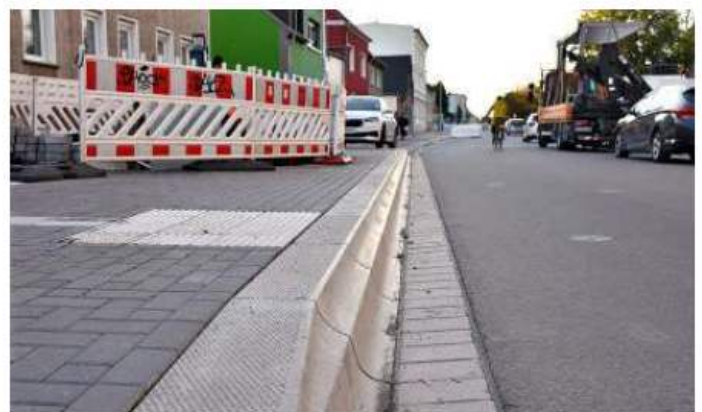
Auf der Südseite ist die Haltestelle „Schäferbreite“ barrierefrei hergestellt worden. Ein erhöhter Bord erlaubt einen hindernisfreien Einstieg.
