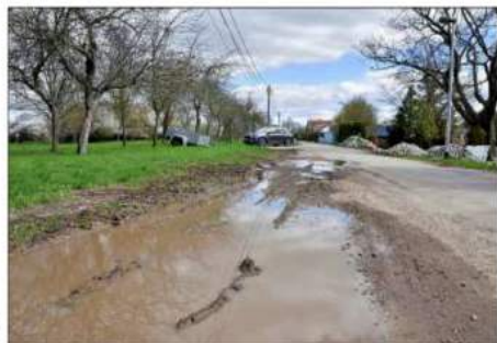
Im Verlauf der Straße „An der Lake“ sind merkbare Schäden sichtbar. Schlaglöcher und zerfahrene Grünstreifen sorgen für Frust bei Anwohnern.
