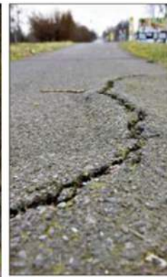
Der Radweg entlang der Salbker Chaussee - hier auf Höhe des Bördeparcs - ist sanierungsbedürftig.
